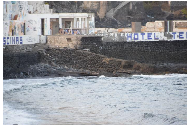
Foto 66. Caseta de bombeo y canalización. Vista desde Paseo Marítimo
