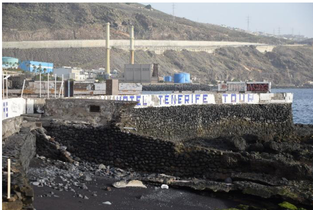
Foto 39. Caseta de bombeo y canalización. Vista desde acceso a la parcela de Tenerife Tour
