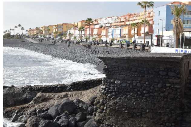
Foto 40. Caseta de bombeo y canalización. Vista desde el interior de la parcela de Tenerife Tour_1
