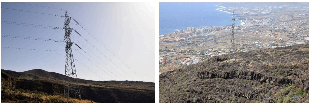
Imagen 16. Torre de Alta Tensión
